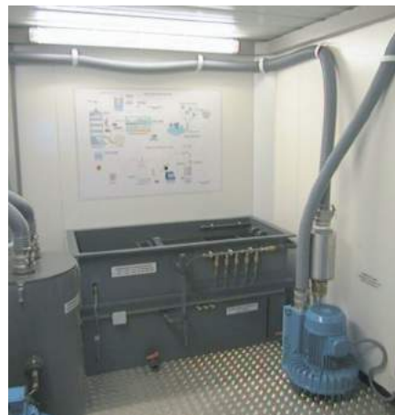
Foto 9. Bomba de vacío
