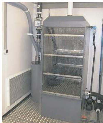
Foto 6. Torre de aireación
