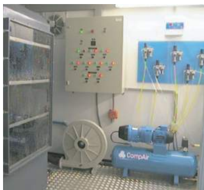
Foto 8. Compresor y soplante
